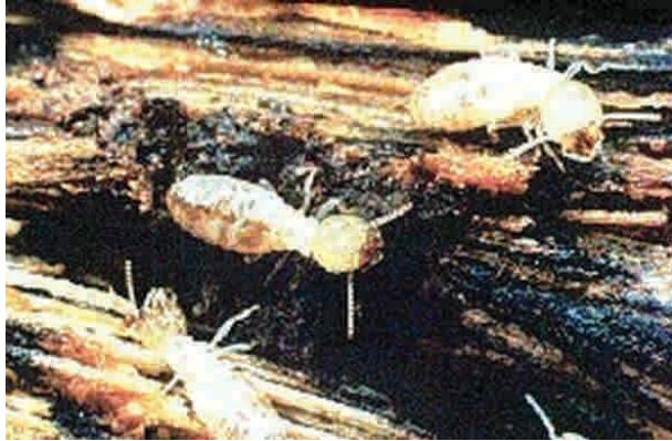
Figura 2 - 10: En la imagen se observan termitas subterráneas en pleno ataque a una solera de un tabique.
