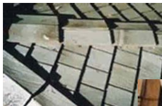
Cubierta de madera sin mantención
